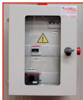
Armario eléctrico con protección de motores, iluminación y señalización
