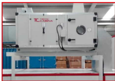
Unidad de aporte y tratamiento de aire situada encima del horno
