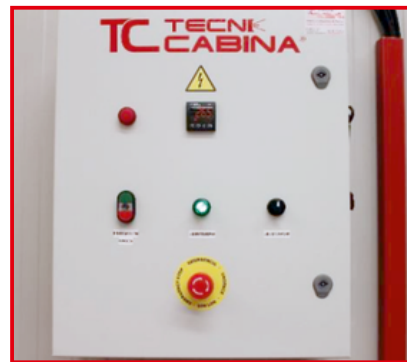
Armario eléctrico con protección de motores, iluminación y señalización
